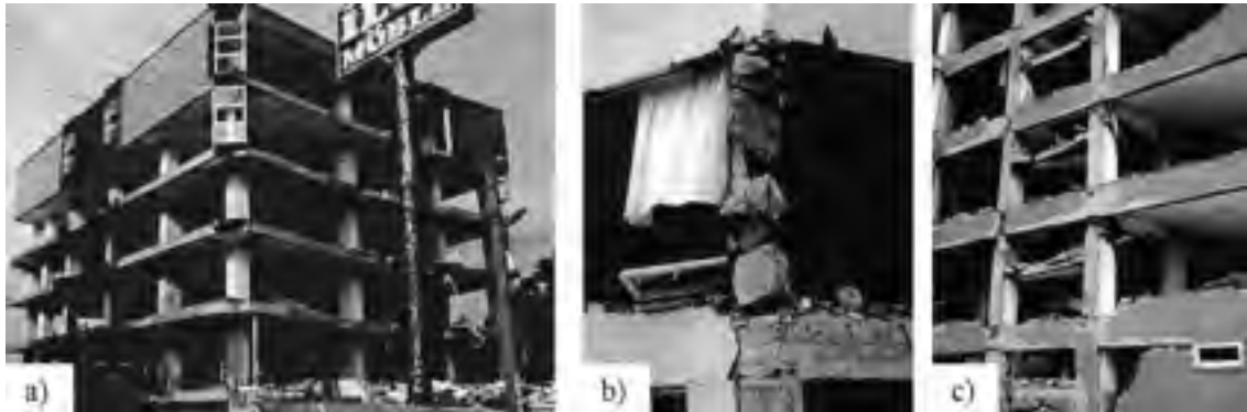
Figure-A XIII-4 a) Dommages à la maçonnerie de remplissage avec quelques colonnes touchées au 1 e étage (flexible); b) manque de confinement de l'armature des colonnes, résultant en l'écrasement du béton ; c) interférence d'éléments non-structuraux avec le système de résistance aux charges latérales : pallier d'escalier affectant les colonnes.
