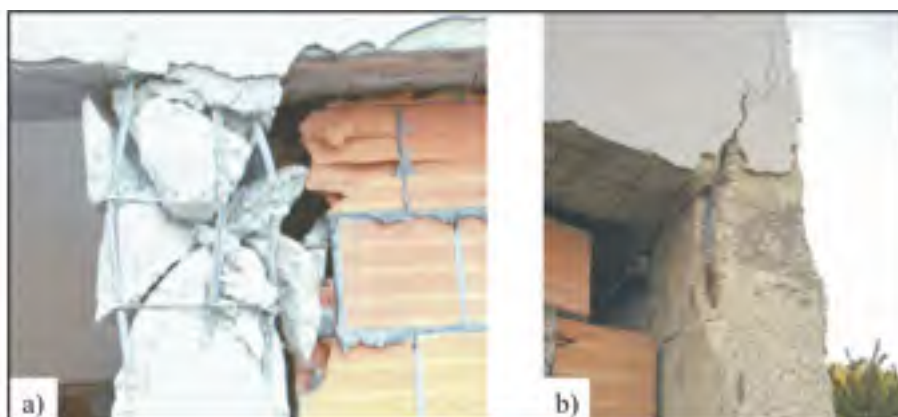
Figure 1.9 Effets de l'interaction entre le mur de remplissage et le cadre vide : a) rupture par cisaillement de la colonne et b) cisaillement à un joint extérieur Tirée de Magenes et Pampanin (2004, p. 2)
