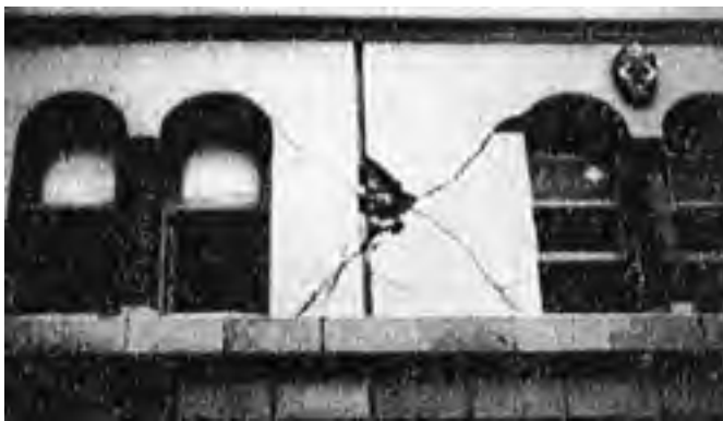
Figure-A XIII-7 Dommage typique extérieur au Palomar Inn : fissure de cisaillement d'une colonne courte (Santa Cruz). Tirée de Bruneau (1991)
