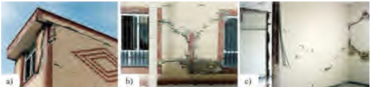
Figure-A XIII-2 Dommages à la maçonnerie : a) parapet et corniche, b) mur de remplissage extérieur, c) cloison.
