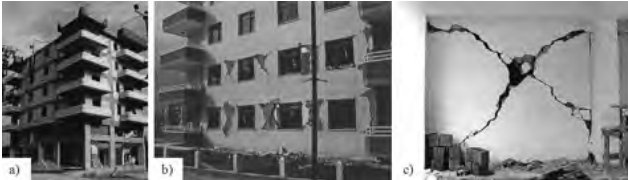
Figure-A XIII-5 a) Bâtiment typique en B.A. et murs de remplissage en maçonnerie ; b) dégâts modérés à un immeuble de 5 étages ; c) fissures en croix caractéristiques dans un mur de remplissage en maçonnerie.
