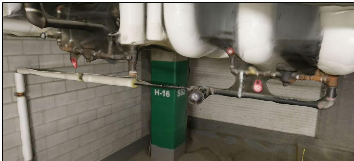
Figure 3.12 Zoom sur la tuyauterie (deuxième stationnement)
