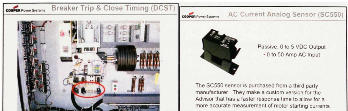
Figure 5.8 Contrôle et surveillance d'un disjoncteur.
