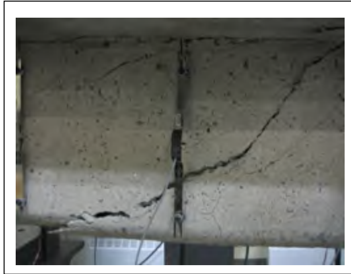
Figure 3.6 Rupture en cisaillement d'une poutre renforcée avec la méthode ETS Tirée de A.Mofidi (2011)
