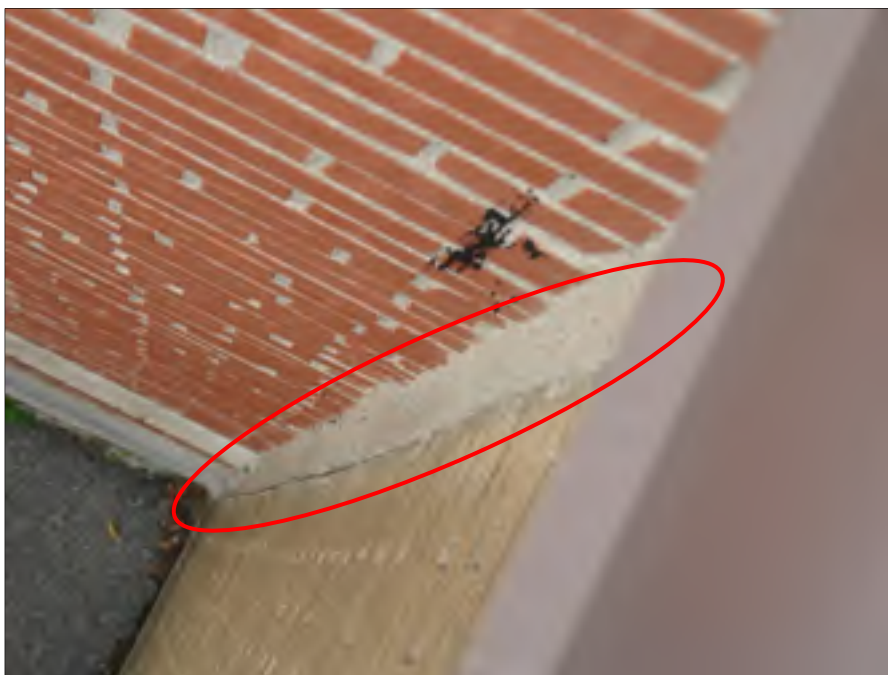
Figure 2.18 Joint de séparation mal conçu d'école primaire (Montréal) entre deux blocs de différentes couleurs de briques
