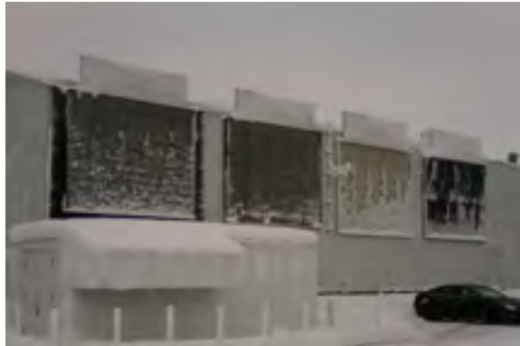
Figure 3.12 Photographie des collecteurs, le 11 décembre 2014
