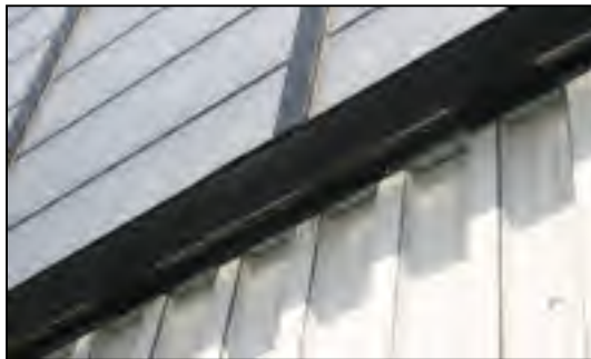
Figure 2.3 Photographie des fentes dans le bas du collecteur TTC
