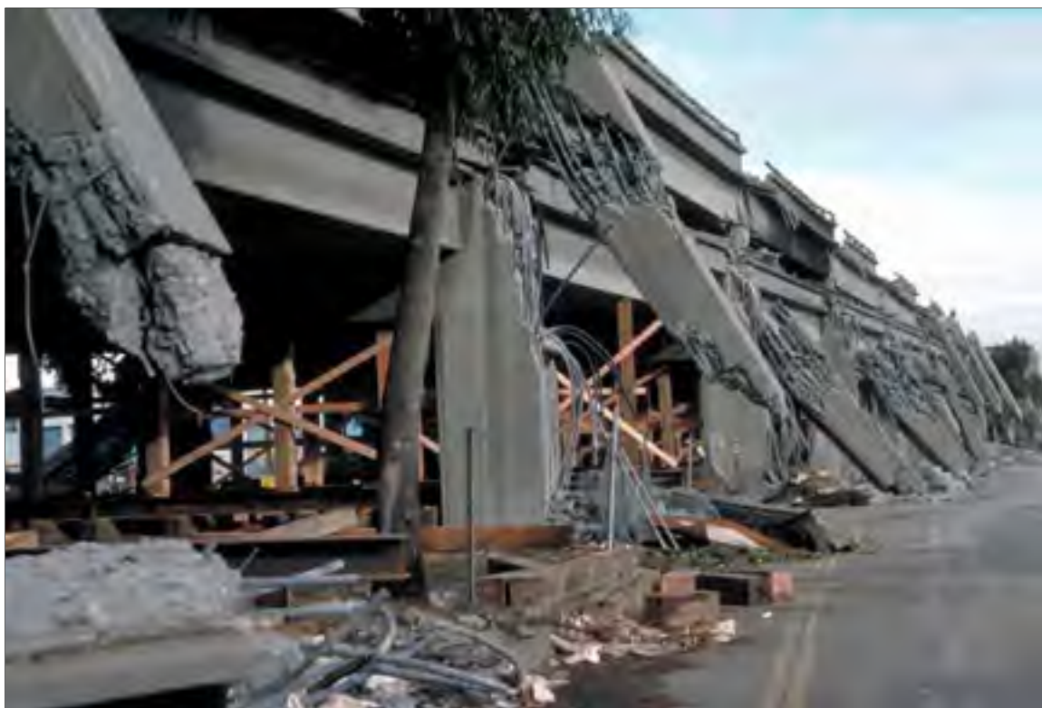
Figure 1.9 Rupture des assemblages, viaduc Cypress (Loma Prieta, 1989) Tirée de Brocher et al. (2014)
