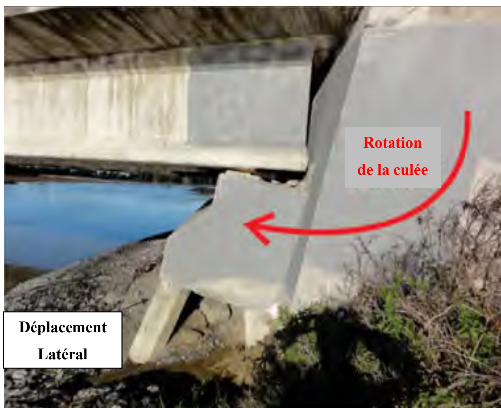
Figure 1.12 Glissement et rotation d'une culée du pont South Brighton Bridge (Nouvelle Zélande, 2011) Adaptée de Cubrinovski et al. (2012)
