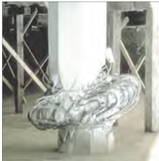
Figure 1.8 Rupture d'une colonne lors du séisme de Northridge (1994) Tirée de Andrawes et al. (2009)
