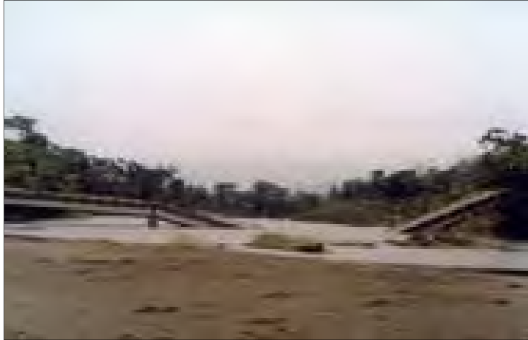
Figure 1.11 Effondrement d'une travée du pont Rio Viscaya au Costa Rica (1990) Tirée de Priestley (1996)
