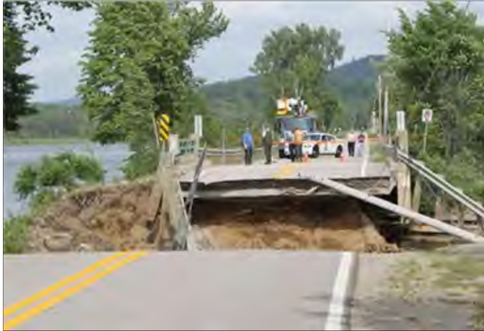
Figure 0.2 Dommages causés par le séisme de Val-des-Bois au Québec sur un pont près d'Ottawa Tirée de Gouvernement du Canada (2010)
