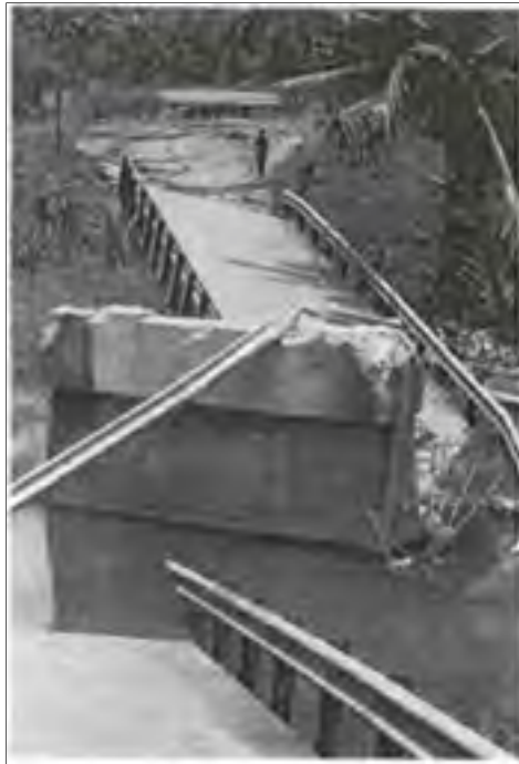
Figure 1.10 Perte d'appui et rupture d'une travée du pont Rio Bananita construit sur des sédiments de faibles résistances au cisaillement, (Costa Rica 1990) Tirée de Priestley (1996)
