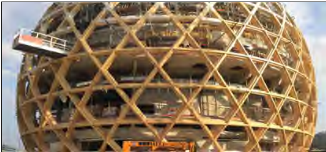
Figure 2.11 La Seine Musicale en cours de réalisation Shigeru Ban et De Gastines Architectes, Usai et Stehling (2018)
