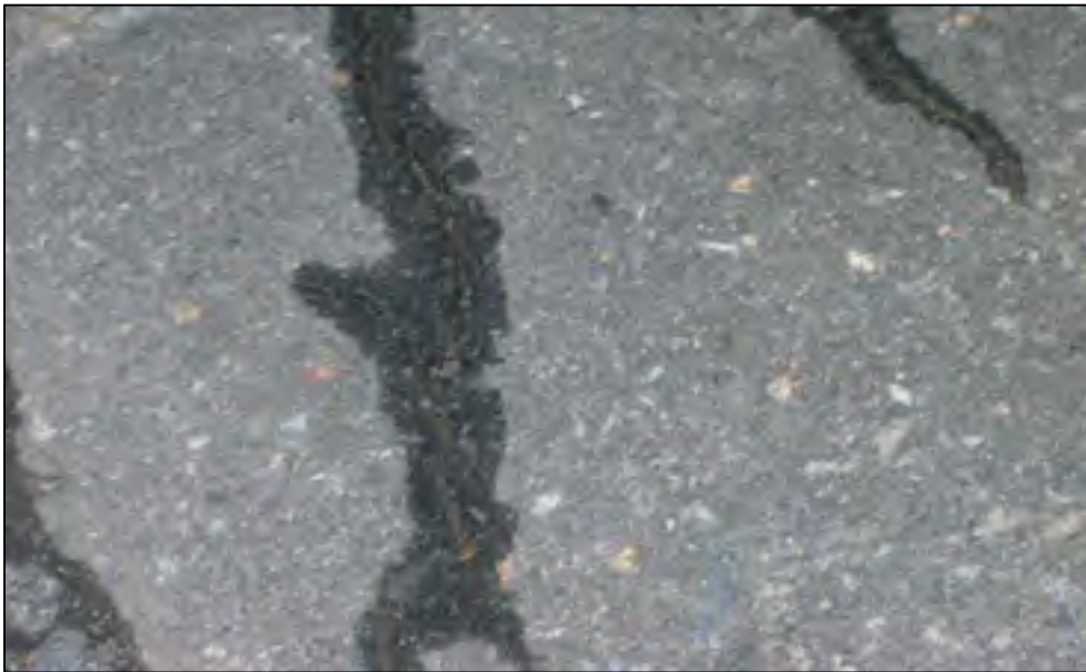
Figure 3-2 Humidité résiduelle sur le site d'une fissure (Bergeron et al., 2012)
