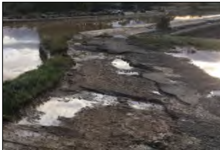
Figure 2.26 Désenrobage d'une chaussée à Trèbes Tirée de San et al. (2018)
