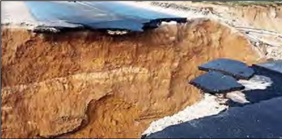
Figure 2.24 Rupture du remblai et de la chaussée Tirée de Tajine (2018)
