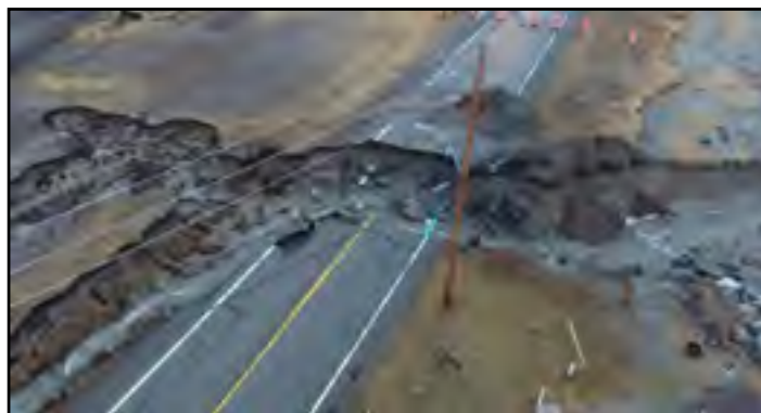
Figure 2.16 Dommages d'une route, Bas-Saint Laurent, Québec, Canada Tirée de Fortin (2018)
