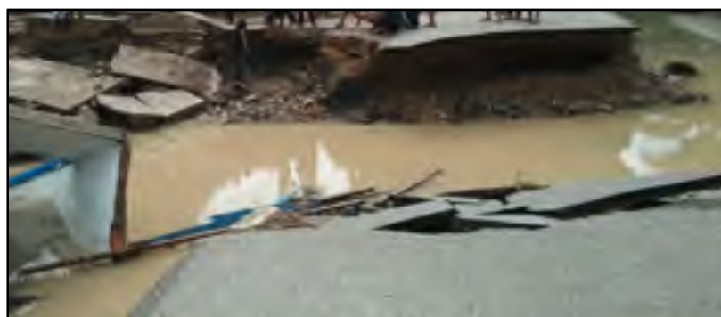
Figure 2.29 Rupture de chaussée Tirée de Sutopo (2018)
