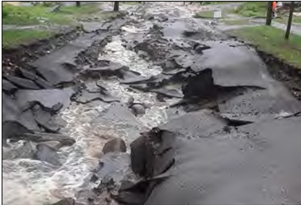
Figure 2.18 Dommage occasionné à une route à Houghton Tirée de Davies (2018)
