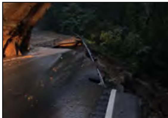
Figure 2.28 Rupture d'une chaussée Tirée de Regenfällen (2018)
