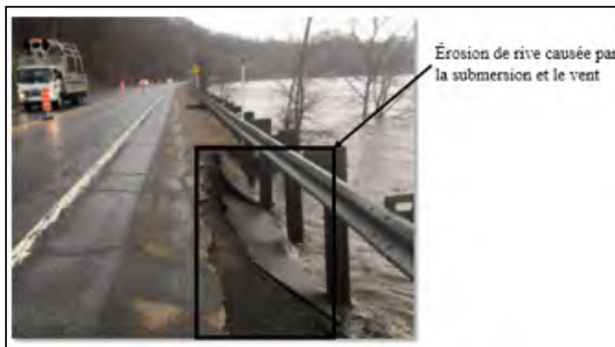
Figure 2.12 Dégâts de la route 153, La Baie-de-Shawinigan Québec, Canada Adaptée de Vaillancourt (2017)
