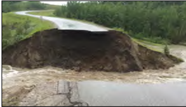
Figure 2.20 Rupture de la chaussée de la route Mason-Semple de l'autoroute 97 Tirée de Davies (2016)
