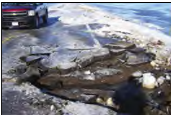
Figure 2.13 Dégâts par érosion Tirée de Briaud & Maddah (2016)
