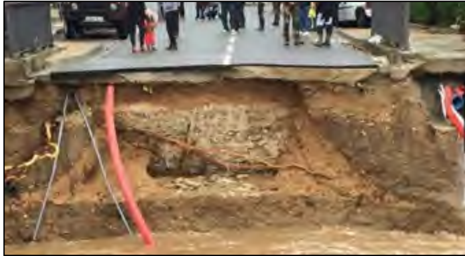
Figure 2.25 Rupture de la chaussée Tirée de Canabis (2018)
