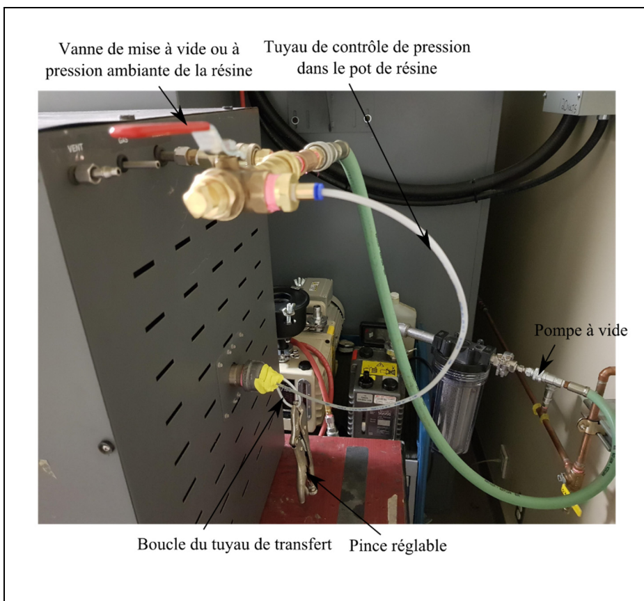
Figure 4.9 Montage de fabrication à l'arrière de l'étuve
