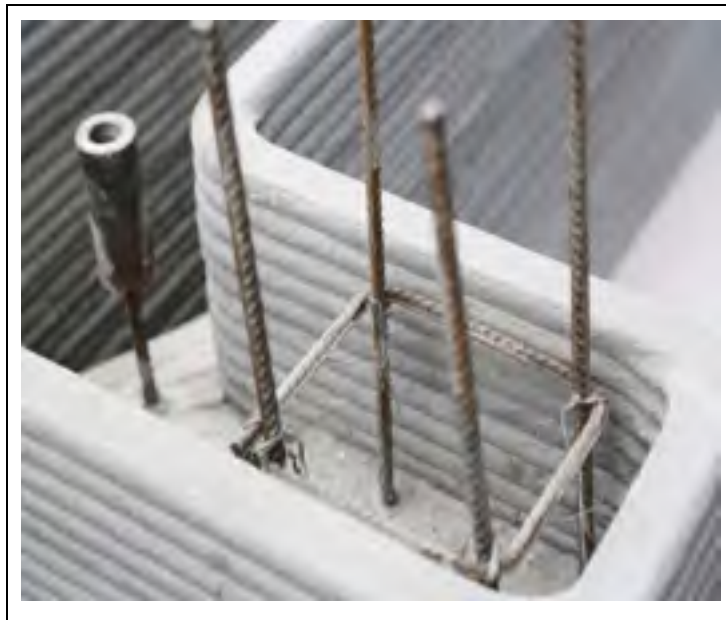
Figure 1.1 Exemple de fabrication avec remplissage dans deux parois imprimées Réalisation de l'entreprise (WinSun, 2015)
