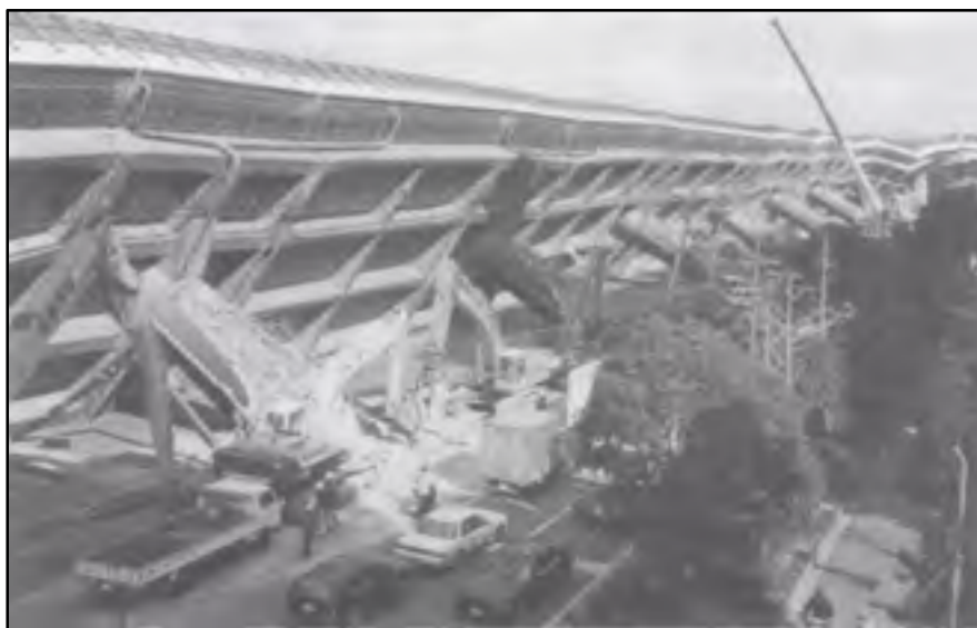
Figure 1.7 Rupture en flexion de piles Tirée de Priestley et al. (1996)
