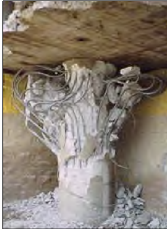
Figure 1.8 Flambement des aciers longitudinaux Tirée de Cooper et al. (1994)
