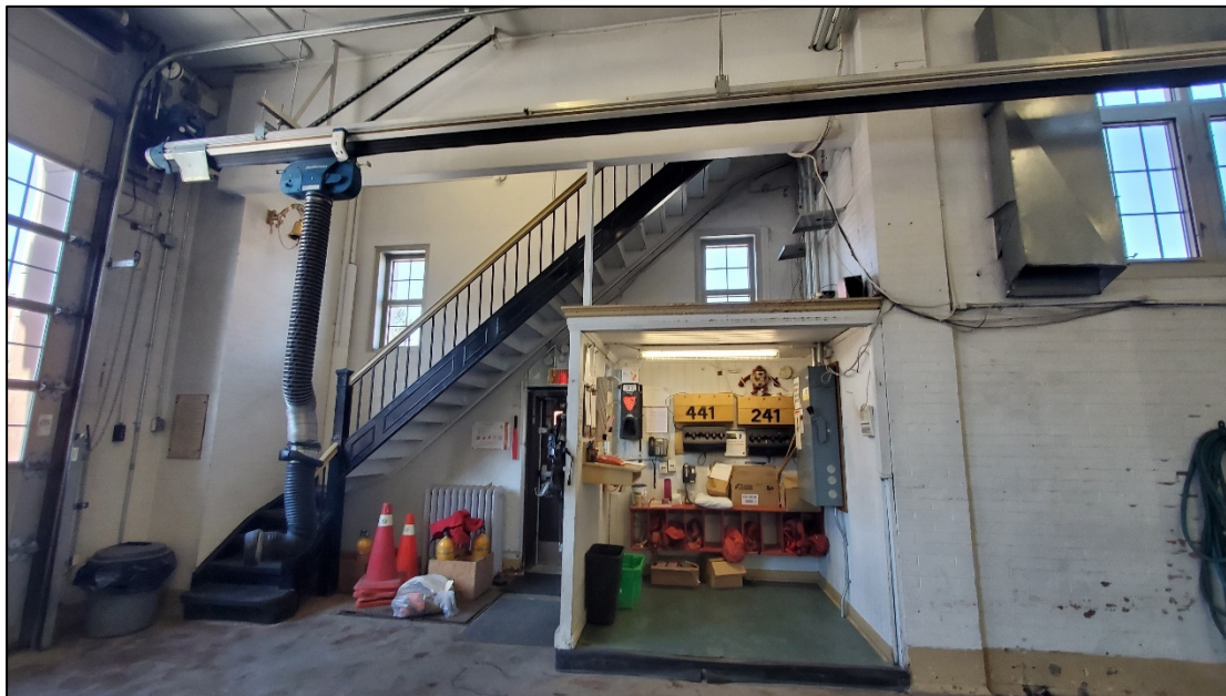
Figure 2.17 Système de captation des gaz d'échappement (conduite mobile + rail)
