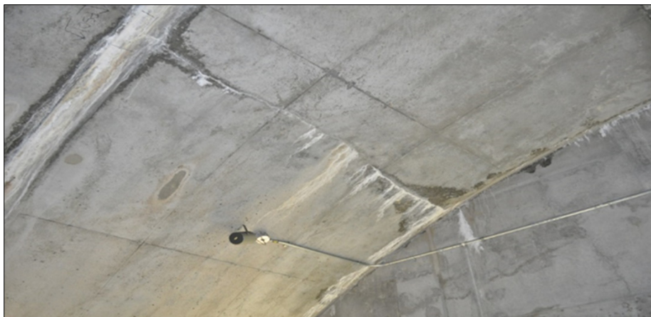
Figure 0.1 Fissure plastique au tiers de la voute dans un tunnel
