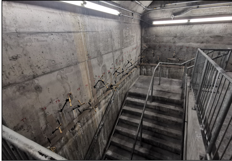
Figure A II-2 Discontinuité horizontale à injecter
