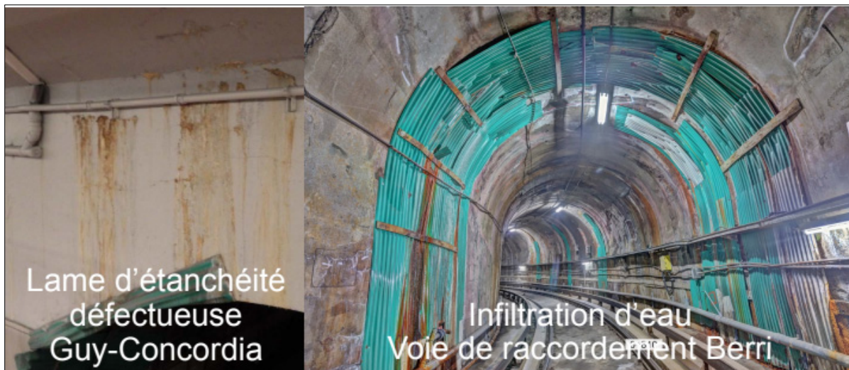
Figure 0.3 Détérioration des finis et béton endommagé Tirée de STM (2018, p.3)
