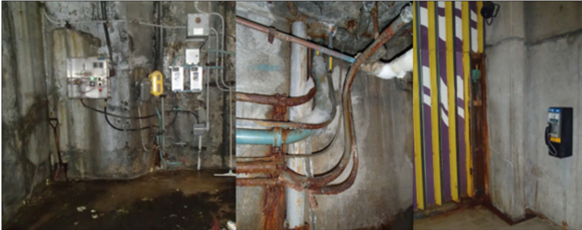
Figure 0.2 Dégradation et corrosion des équipements Tirée de STM (2018, p.3)
