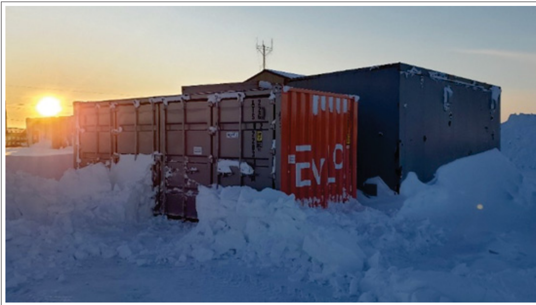
Figure 1.4 Système BESS fabriqué par EVLO (2024)
