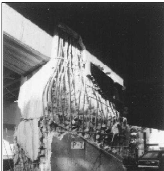
Figure 1.19 Rupture d'une colonne due à un manque d'armatures à mi-hauteur. (Tiré de Chen et Duan, 2003)
