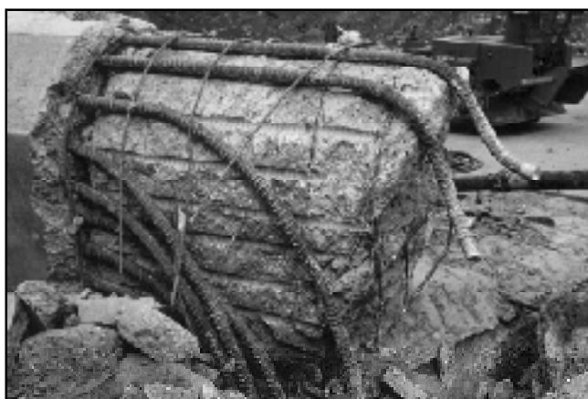
Figure 1.17 Effondrement d'une colonne dû à un problème de connexion avec la fondation.
