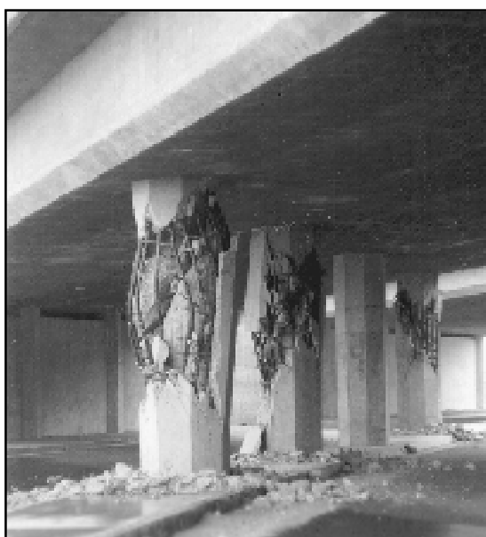
Figure 1.20 Ruptures en cisaillement dues à un manque d'armatures de confinement. (Tiré de Chen et Duan, 2003)
