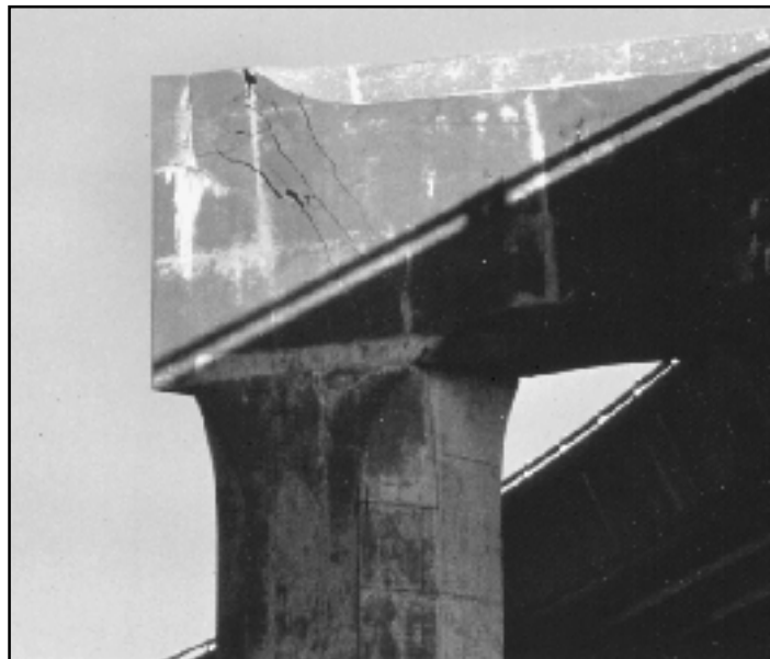
Figure 1.21 Fissuration au niveau de l'encastrement entre une poutre et une colonne.
