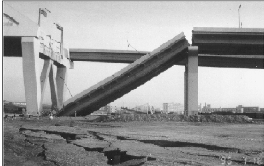
Figure 1.22 Échappement d'une travée lors du séisme de 1995 à Kobe. (Tiré de Chen et Duan, 2003)
