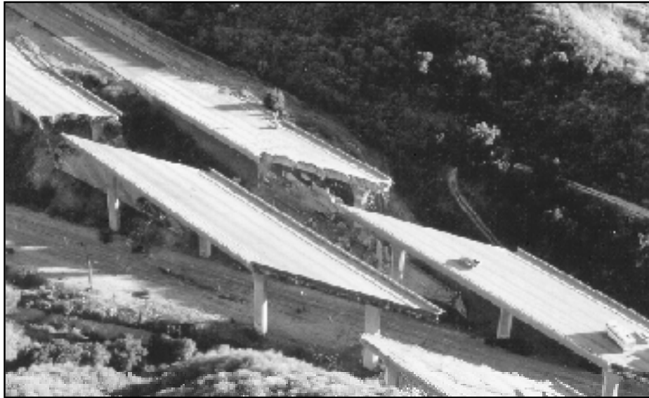
Figure 1.25 Effondrement de travées sur un pont biais au niveau des joints de dilatation, Northridge 1994.
