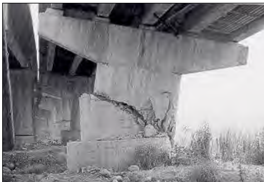
Figure 2.11 Rupture des piles par cisaillement. Tirée de Tiré de CTOA (1999)
