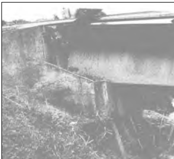
Figure 2.13 Glissement des culées. Tirée de Priestley et coll. (1996)
