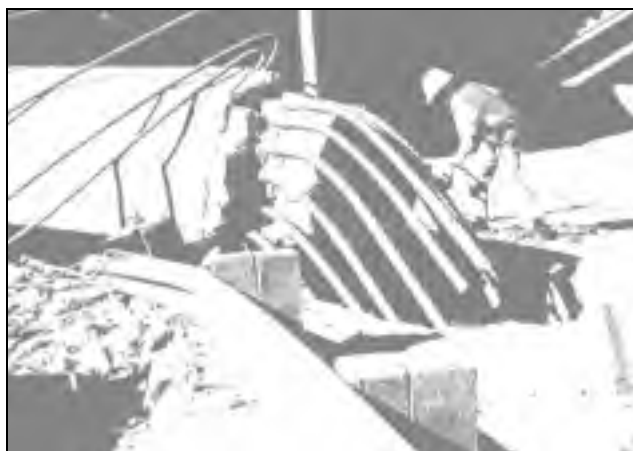
Figure 2.7 Rupture de l'armature à la base d'une colonne (San Fernando 1971). Tirée de Priestley et coll. (1996)
