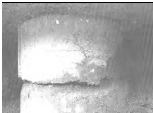
Figure 2.12 Dommages observés sur une tête de pieux. Tirée de STOA (STOA et coll., 1999)
