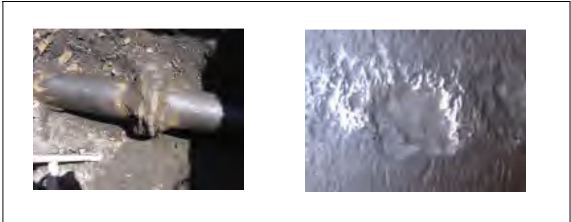
Figure 5.58 Phénomène de graphitisation de la conduite- Rue AR-GX2.
