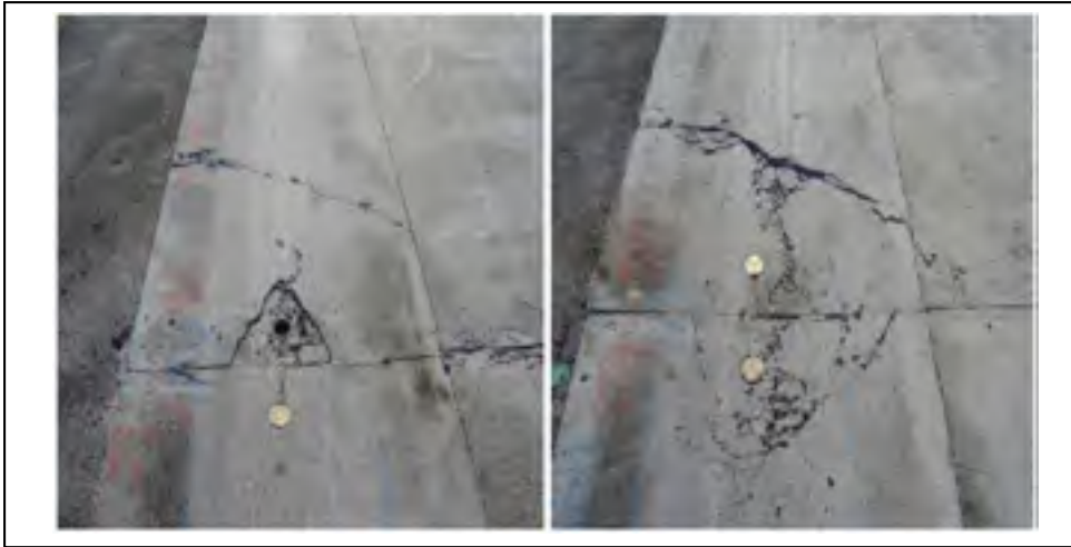
Figure 3.14 Exemple type d'endommagement des chaussées rigides Tirée de Kohler (2007, p. 279)
