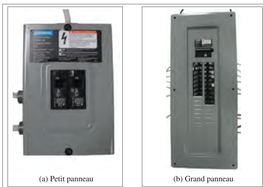
Figure 3.13 Panneaux de disjoncteurs
