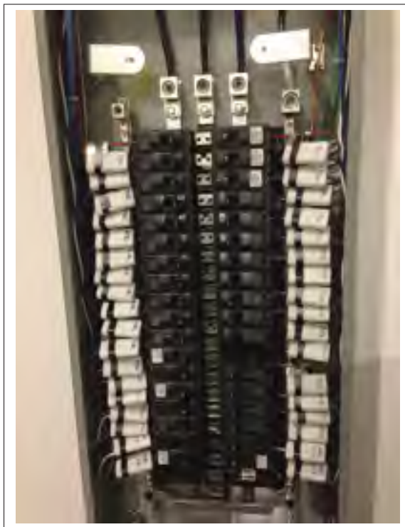
Figure 0.6 Système installé dans un panneau électrique
