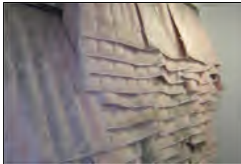
Figure 5. 9 Filtres de la salle mécanique
