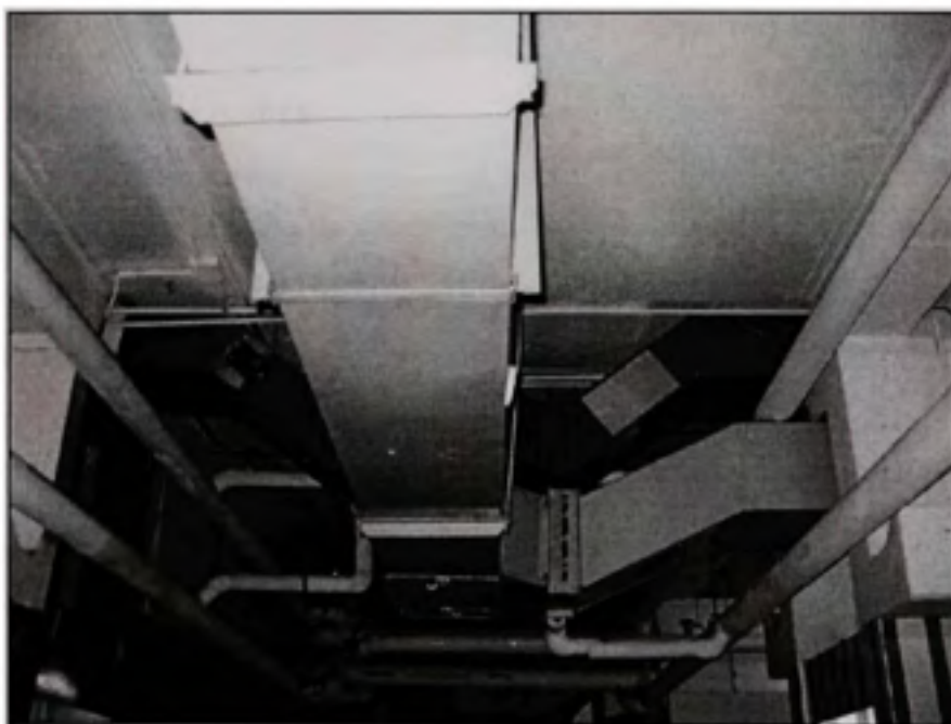
Figure 3.36 Conduits d'aération d'un corridor d'une école polyvalente.
