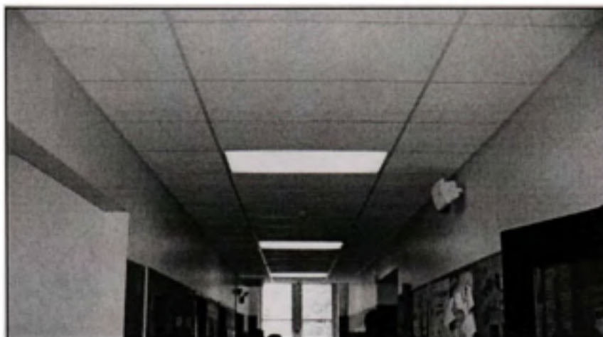
Figure 3.26 Luminaires encastrés dans le faux-plafond.
