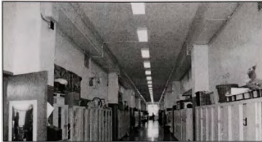
Figure 3.28 Luminaires vissés au plafond.
