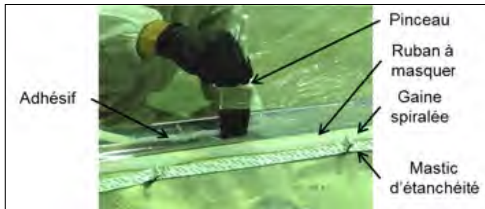
Figure 5.17 Application de l'adhésif sur le côté intrados du joint de la pièce d'acier
