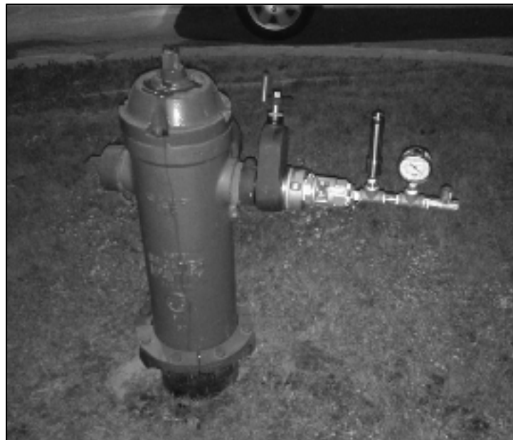
Figure 3.17 Manomètre et enregistreur de données installés sur le poteau d'incendie situé le plus près du point représentatif de zone du secteur résidentiel étudié de Saint-Jean-sur-Richelieu
