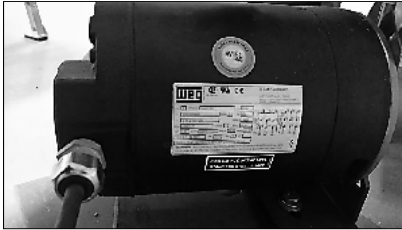
Figure 3.7 Pompe Weg LR 38324
