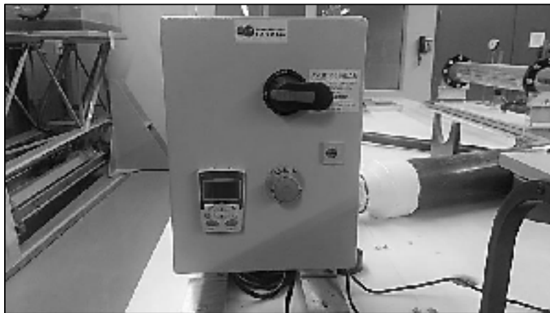
Figure 3.8 Panneau de contrôle de la pompe
