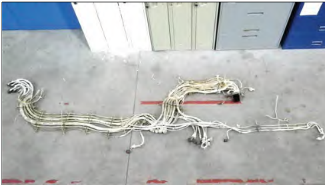
Figure 3.1 Exemple d'un faisceau issu de la cabine
