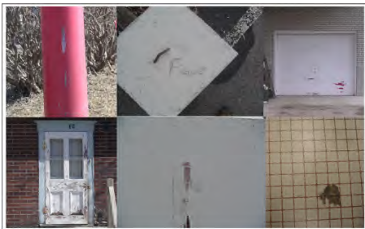
Figure 4 Exemples réels d'effets de détérioration.
