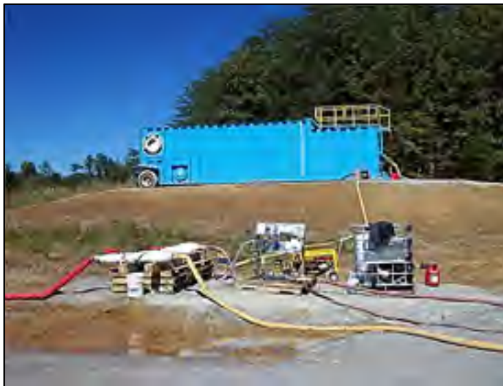
Figure 1-7 Système de préparation, de pompage de polymère, et pompage du mélange (polymère + boues) vers des tubes géotextiles
