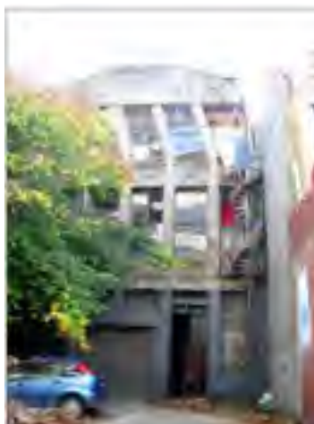
Figure 1.6 Rupture des piliers par balancement
