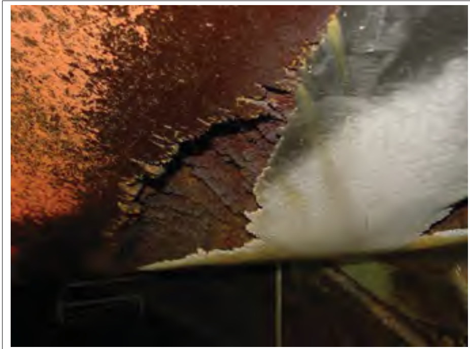
Figure 3.2 Photo d'une aube érodée par cavitation
