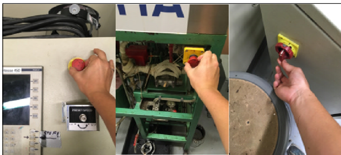
Figure A I-1 Vérification des boutons d'urgence
