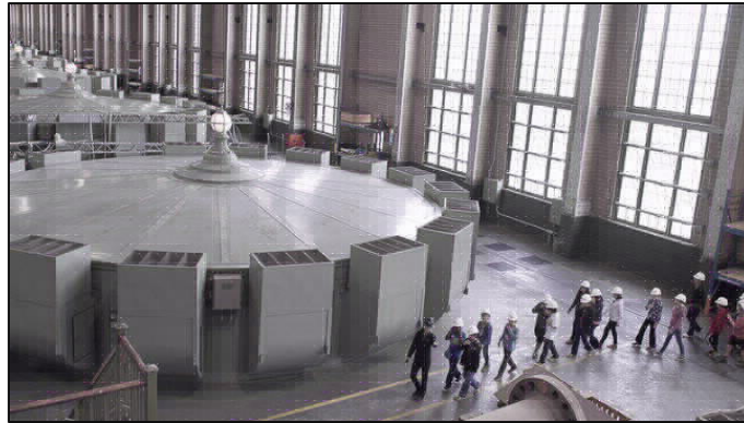
Figure 3.6 Groupe turbine-alternateur d'une centrale d'Hydro-Québec (Hydro-Québec, 2017)
