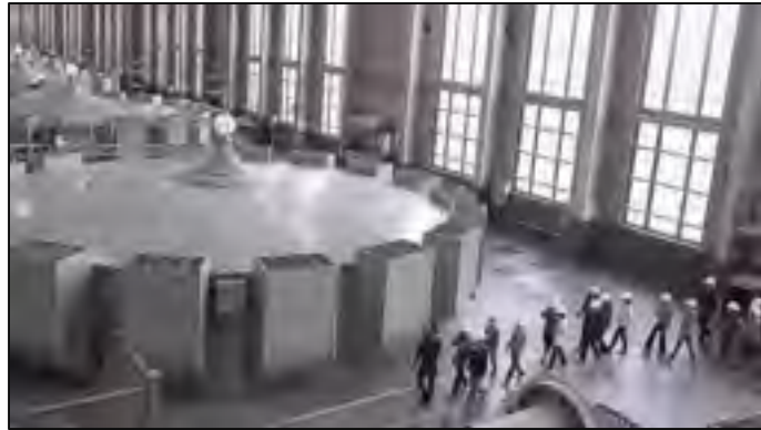
Figure 3.6 Groupe turbine-alternateur d'une centrale d'Hydro-Québec (Hydro-Québec, 2017)
