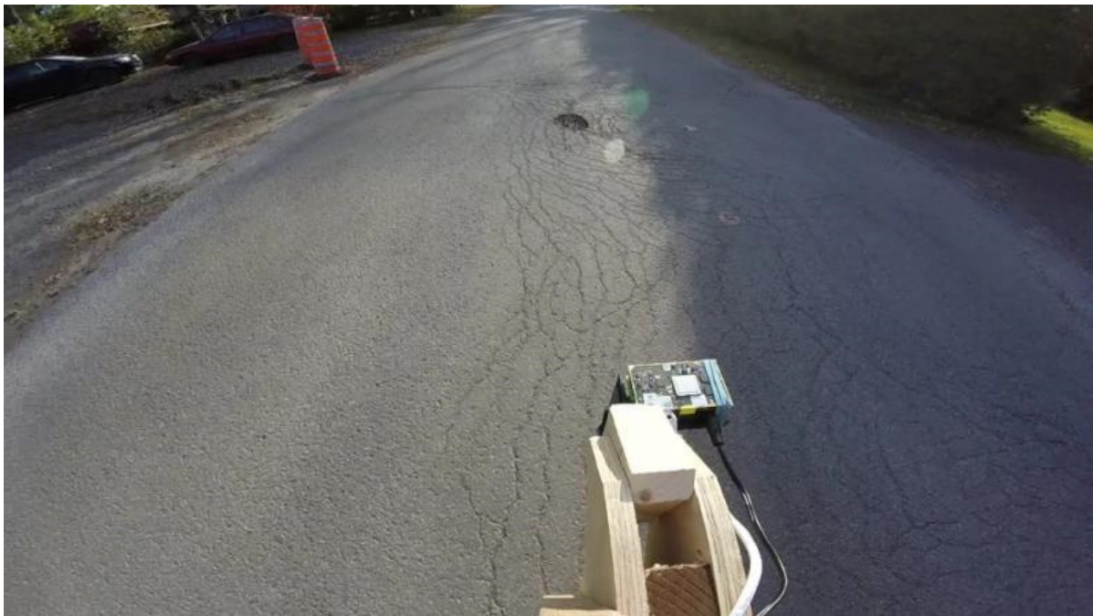
Figure 6.4 Image 54 fissure longitudinale, nid-de-poule et fissure en carrelage alligator
