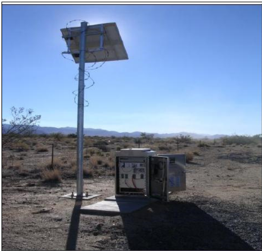
Figure 3.19 Fin de l'installation électrique; connexion des câbles au cabinet pour acquérir et transmettre les données (IRD, 2001)
