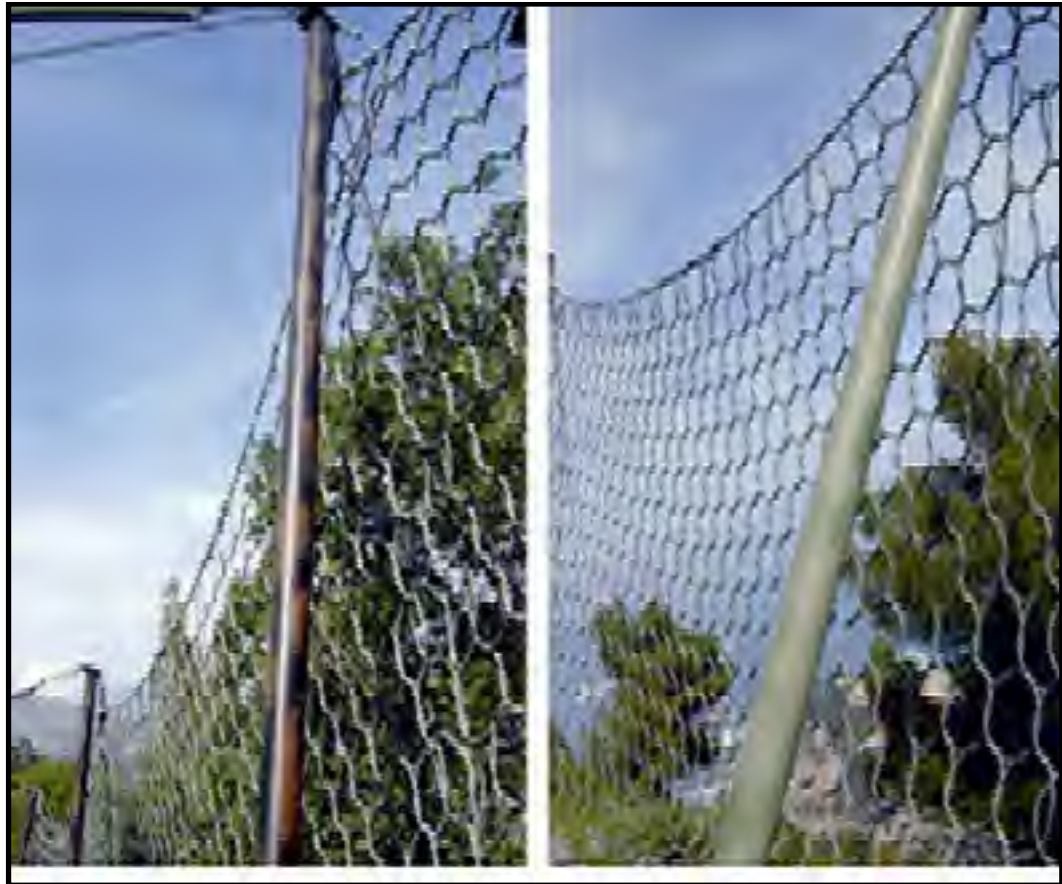
Figure 0.40 Filets de protection déformables Tirée d'Ansaldi et Guglielmetti (2016)
