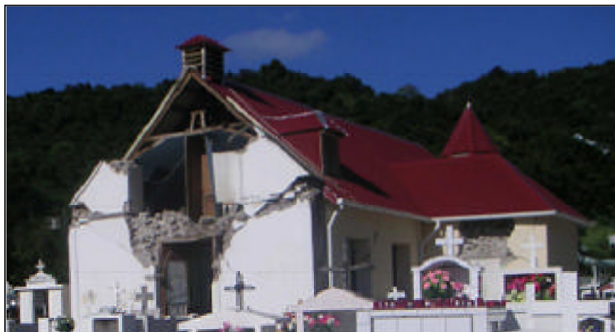
Figure 1.10 Église endommagée - Guadeloupe 2004 séisme de magnitude 6.4 ( m_b et M_w ). Tirée de Zacek (2008)
