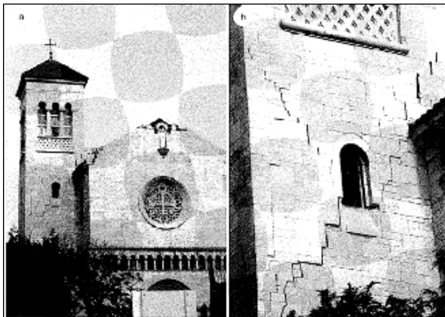
Figure 1.8 Modes de rupture observés à l'église de Santa-Monica.
