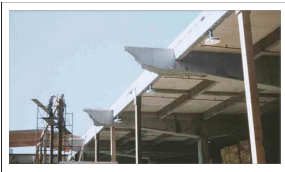
Figure 2.4 Rupture en cisaillement des poutres de l'entrepôt Wilkins à Shelby https://fr.slideshare.net/AsadullahMalik/final-year-project-presentation-june-2015-investigation-of-shear-behaviour-of-slender-beams-using-finite-element-analysis (Consulté au mois de décembre 2020)
