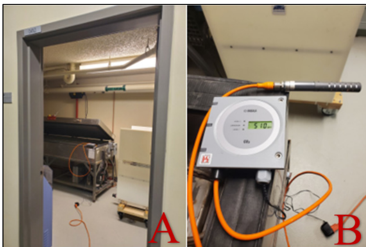
Figure-A III-11 Sondage de la concentration en CO 2 dans la salle de cure; photo A : localisation de la sonde au centre de la pièce de cure; photo B : lecture de la sonde à CO 2
