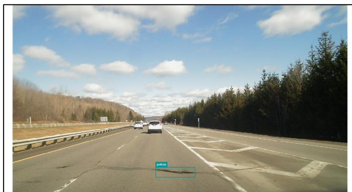
Figure 3.8 Exemples d'un crack horizontal
