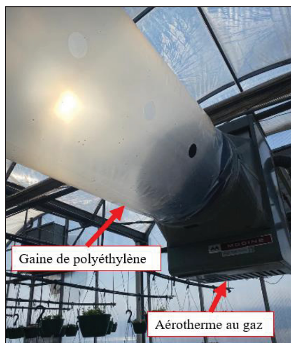
Figure 1.3 Chauffage par ventilo-convecteur et gaine de polyéthylène perforé (Ken-Bar Inc., s.d.)
