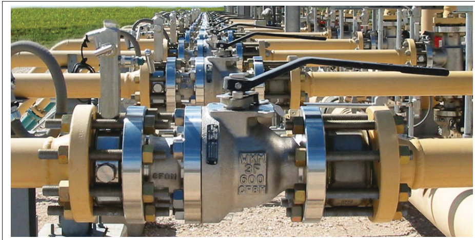
Figure 1.2 Exemple de nombreux montages d'assemblage à brides boulonnées dans une zone industrielle
