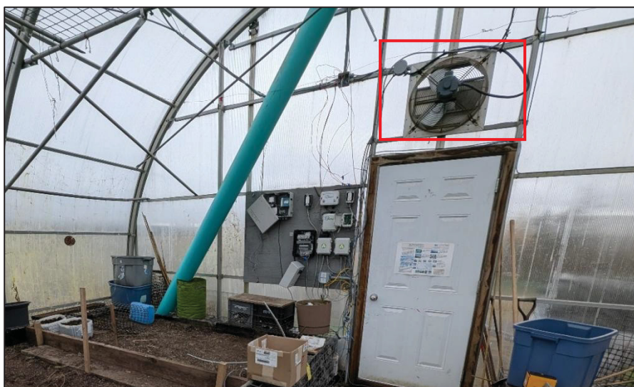
Figure 1.10 Ventilateur à pression positive d'une serre à Kuujjuaq, Nunavik
