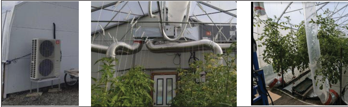
Figure 3.7 Thermopompe, unité de traitement d'air et ballons d'airs chauds (serre 3)
