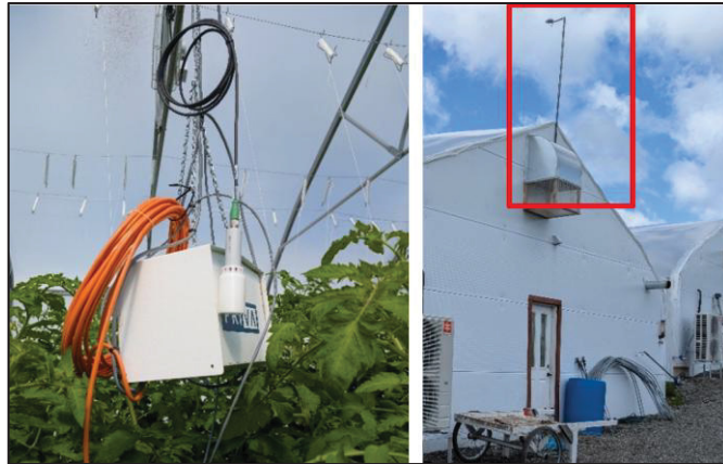
Figure 3.2 Boîtier avec les sondes de température et d'humidité et station météo sur son mât
