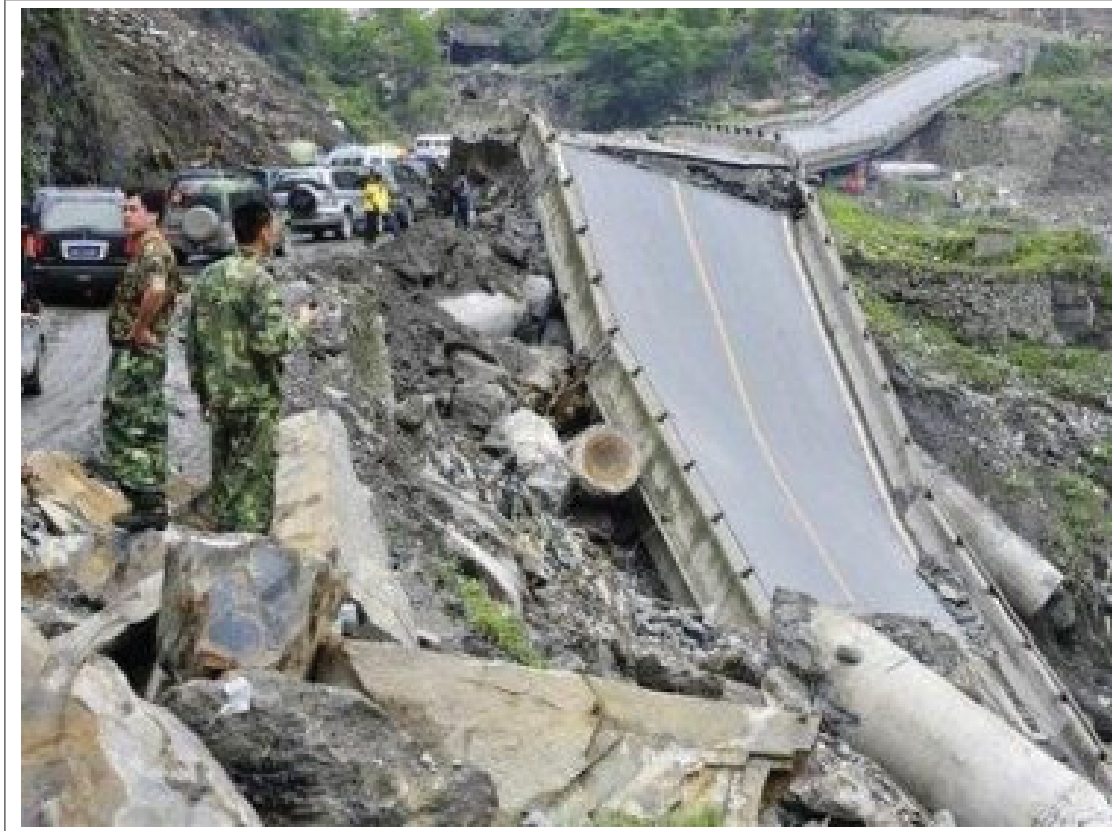
Figure 1.1 Soulèvement de routes impraticables après le séisme du 12 mai 2008 dans la ville de Wenchuan (Chine)[Google/DigitalGlobal]
