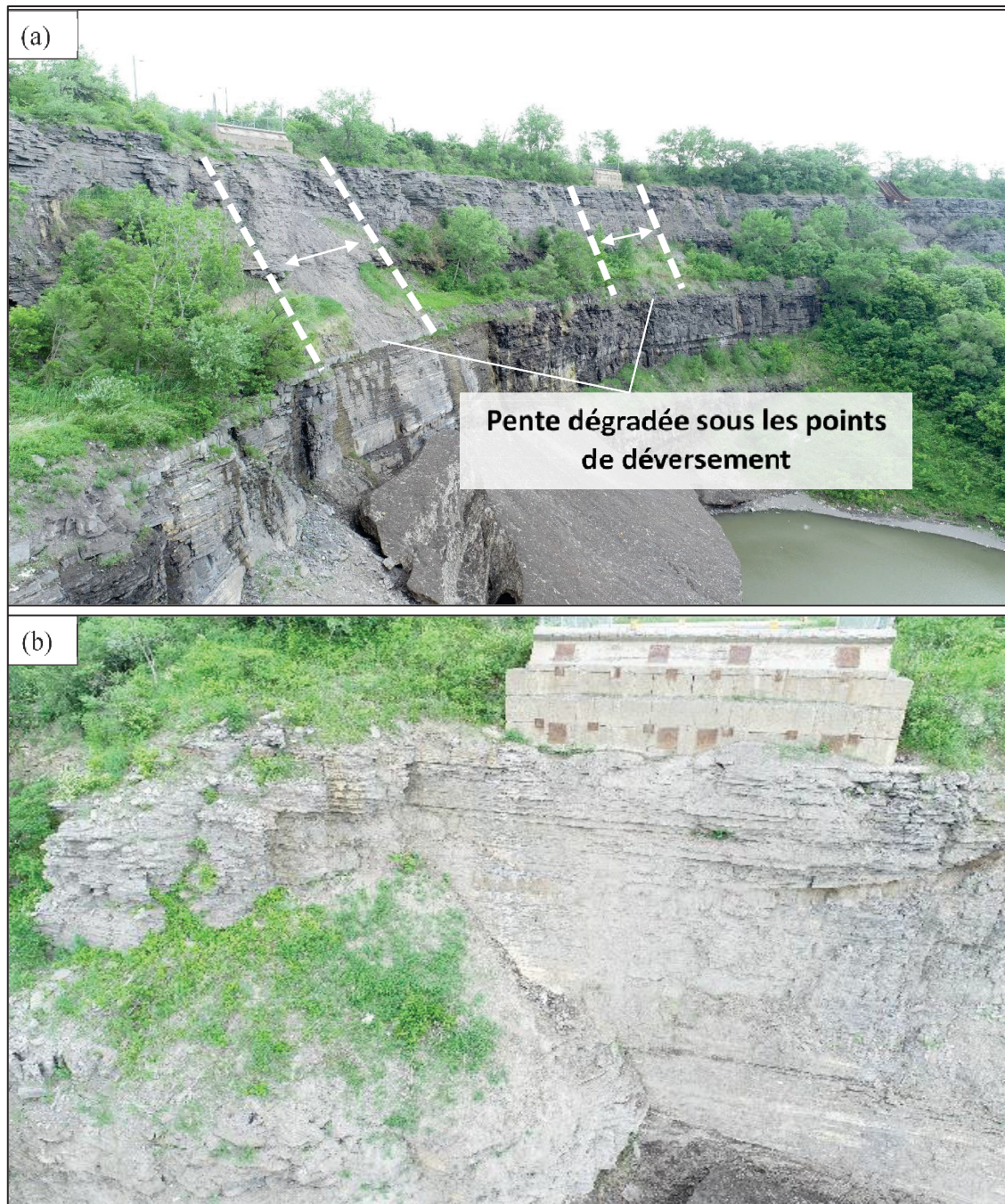
Figure 3.26 Effets morphologiques potentiels des opérations de dépôt de neige sur les parois de la carrière Francon : (a) pentes dégradées sous les points de déversement ; (b) répétition de zones érodées en partie haute de la paroi, près des quais. Ces formes sont compatibles avec une influence opérationnelle locale, sans constituer une preuve directe de causalité
