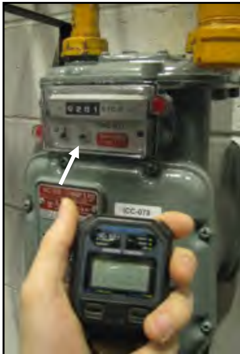
Compteur de gaz
