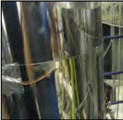
Thermocouple mesurant la température de la paroi extérieure
