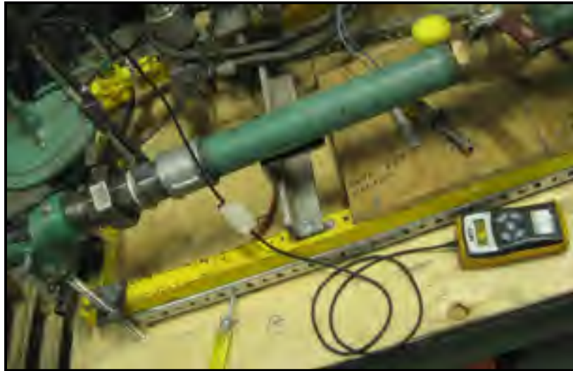
Fil chaud et anémomètre sur le gros brûleur
